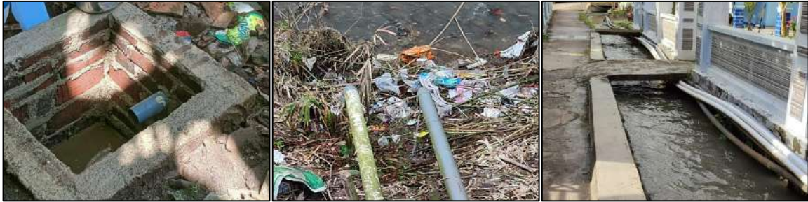
Gambar 3.9 Bak Penampung (Kiri); Pipa Non Tinja (Tengah); Drainase Lingkungan (Kanan)
